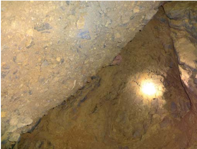
Abb. 15: Hochbruch in einem phantomisierten Bereich der Gesteine der Tonplattenfazies. Deutlich erkennbar ist der hier vollständig aufgelöste und in Isoalterit umgewandelte Gesteinsverband.
