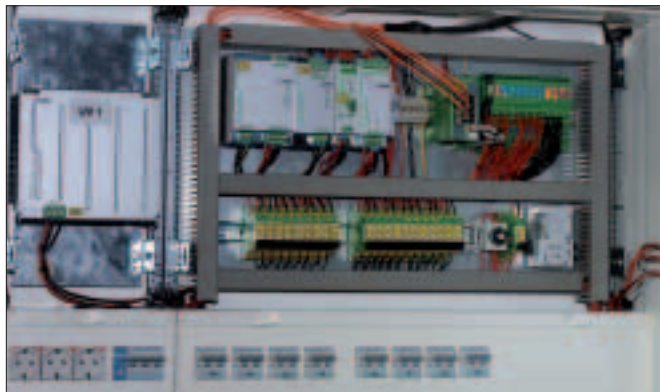
Abb. 2: Blick in einen neuen Elektro-Unterverteiler: Moderne Steuerungstechnik und unterbrechungsfreie Stromversorgung gewährleisten einen sicheren Betrieb der Schauhöhle; Foto Oliver Heil
